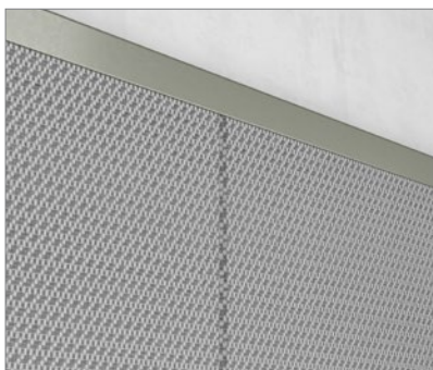
Huomaamaton liittymä seinävaimennuslevyjen ja alumiinikehyksisten profiilien välillä.
